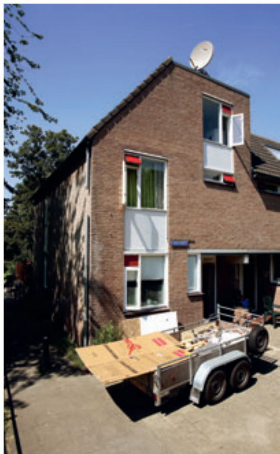
In een woonhuis in Utrecht installeerde Eneco begin augustus de eerste hre-ketel van de Italiaanse fabrikant Ariston.
