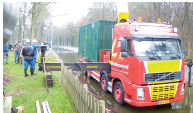
De WKK met generator, warmtepomp en motor zit in een container die op speciale manier getransporteerd en op zijn plaats gezet moest worden.
