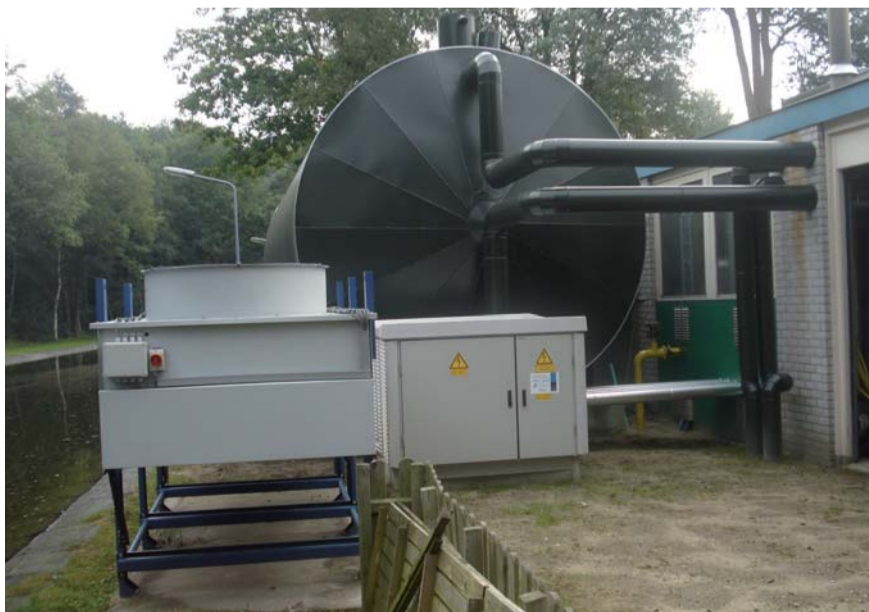
De cooler met buffertank van 120 m 3 voor ondersteuning van verwarmen van het zwembad.
