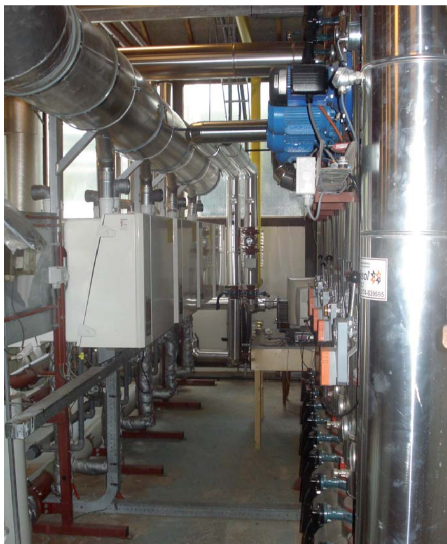
De verdelerpijpen rechts brengen de warmte van de WKK naar de diverse baden, links een aantal HR-ketels die in actie komen als er veel vraag is naar warmte.
